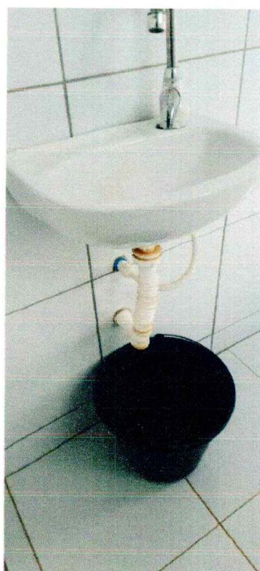
Revisão hidráulica (Sifão)
