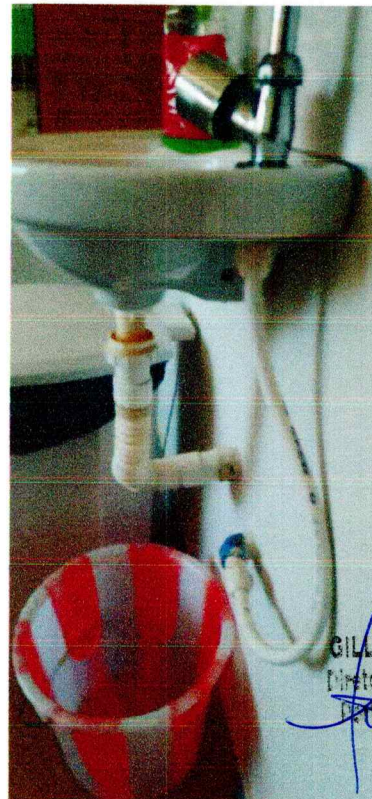
Revisão hidráulica (Sifão)
