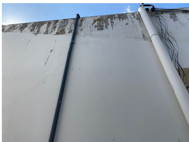
PAREDE DO QUADRO DE DISTRIBUIÇÃO
