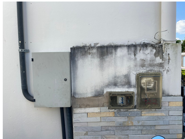
QUADRO DE DISTRIBUIÇÃO - EXTERNO
