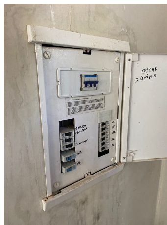
QUADRO DE DISTRIBUIÇÃO
