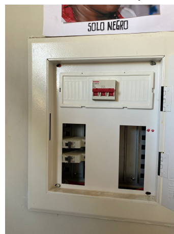
QUADRO DE DISTRIBUIÇÃO – INTERNO
