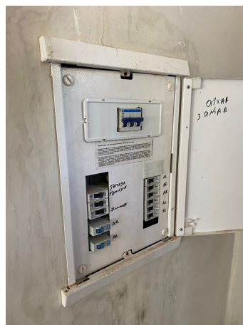
QUADRO DE DISTRIBUIÇÃO
