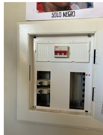
QUADRO DE DISTRIBUIÇÃO - INTERNO
