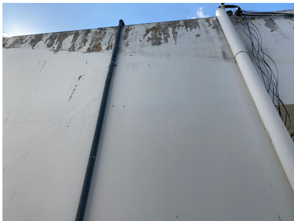
PAREDE DO QUADRO DE DISTRIBUIÇÃO
