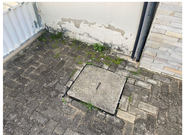
CAIXA DE INSPEÇÃO
