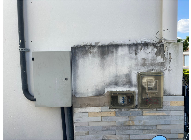
QUADRO DE DISTRIBUIÇÃO - EXTERNO
